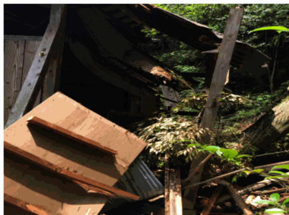
七面宮裏側破損部分
